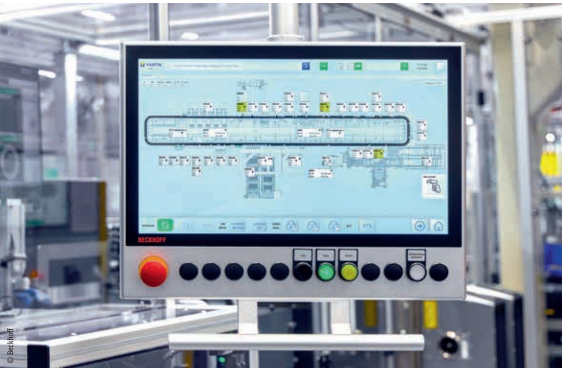
尽管系统结构复杂,但通过带按键扩展功能的倍福多点触控控制面板,仍可实现清晰显示和便捷操作
