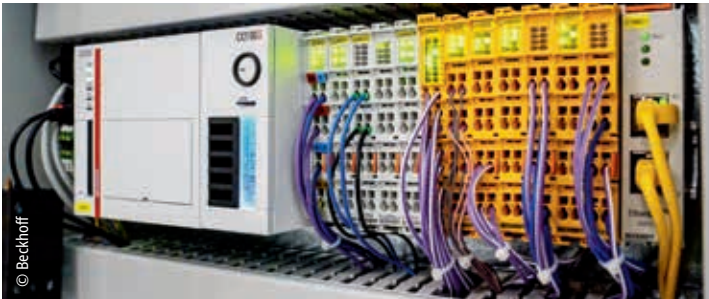
Cx2043 嵌入式控制器以及紧邻配置的 130 W CX2100-0014 电源、EtherCAT 和 TwinSAFE 端子模块, 共同构成了 MIRACLE II 项目的控制硬件
