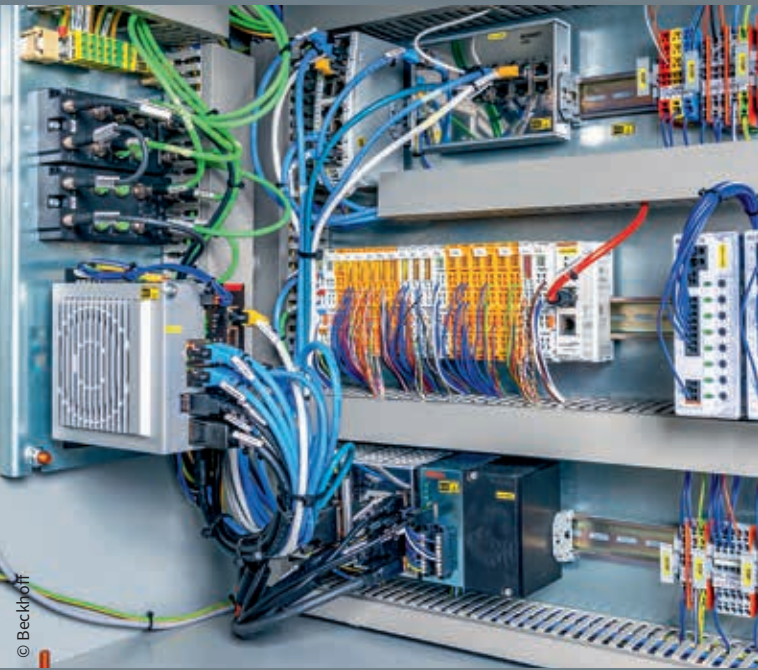
控制柜内部清晰呈现了倍福多个组件的应用 — 从 C6032 超紧凑型工业 PC、CU8803 CP-Link 4 发送器盒、CU8130-0240 后备式 UPS，到 EtherCAT 端子盒以及 EtherCAT 和 TwinSAFE 端子模块
