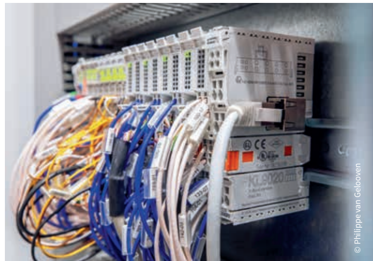
数十台 CX5230 嵌入式控制器与 120 多个 BK9050 TCP/IP 耦合器协同工作，采集暖通空调、给排水、电力、照明、遮阳和消防等子系统中的所有数据
