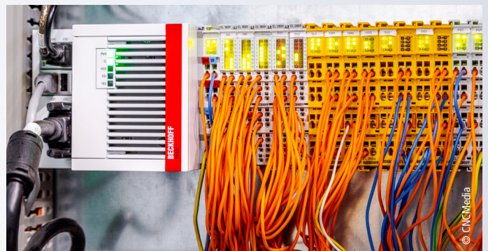
PTL 4001 光纤激光切割系统的核心控制组件包括一台安装有 TwinCAT 3 软件的 CX5130 嵌入式控制器和各种 EtherCAT 端子模块，如 EL1904 TwinSAFE 端子模块和 EL3161 模拟量输入端子模块
