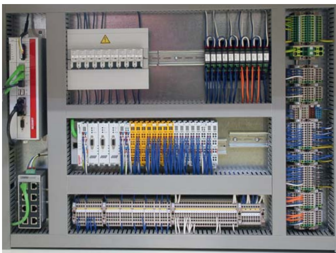
某个加工工位的中央控制柜
